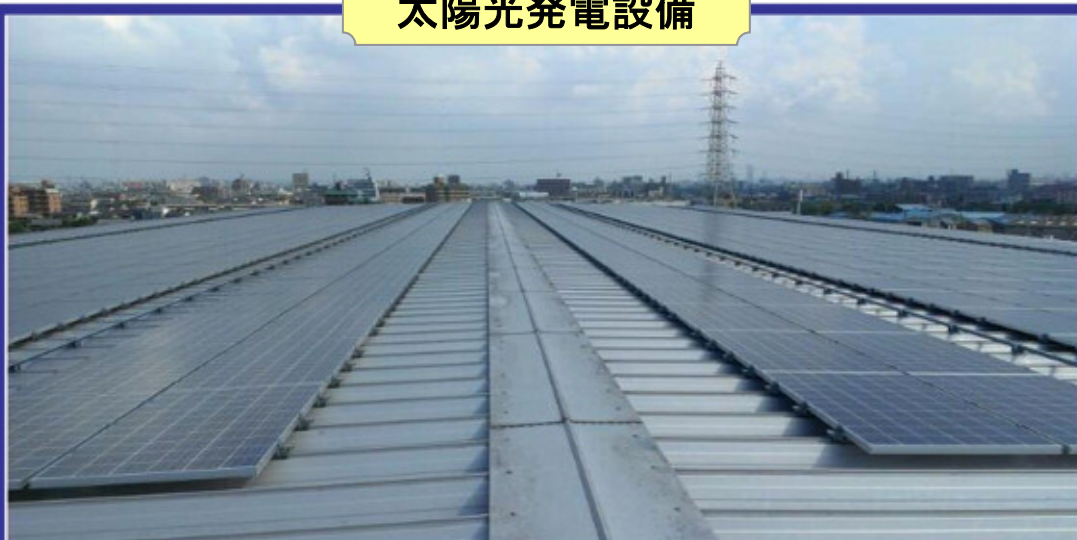
太陽光発電設備
