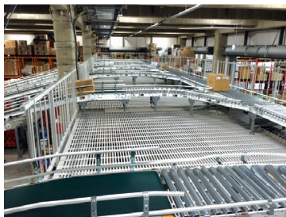
吉見営業所に導入したコンベア設備
